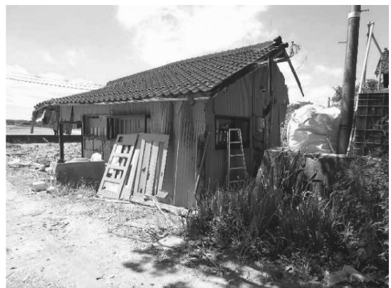
(⑦)により家が壊れている様子
